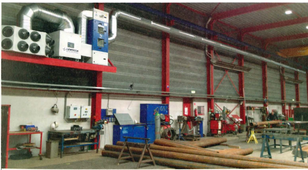
Die »Blowtec« von Teka sorgt beim niederländischen Unternehmen SEW für ein gut reguliertes Raumklima.
